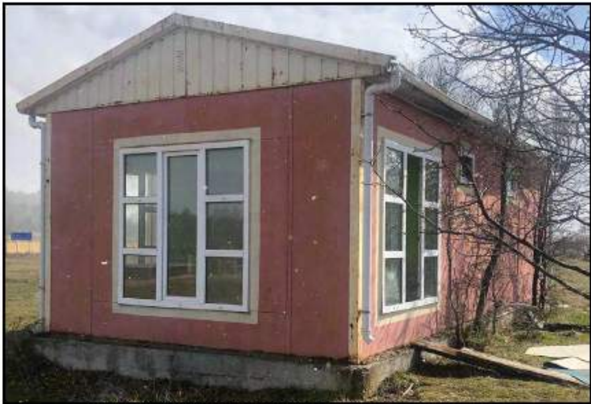
MERKEZ KAVAK KÖYÜ 192 ADA 1 PARSELDE BULUNAN OFİS AMAÇLI KAÇAK YAPI
